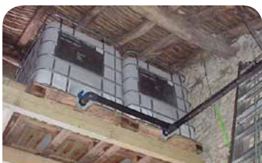
Cuve de pré stockage (ou réserve d'eau intermédiaire)
