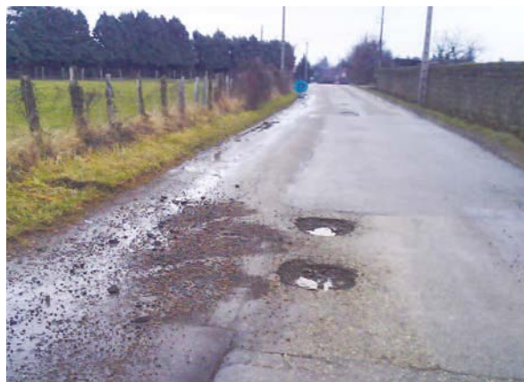
Dégradation de la voie
